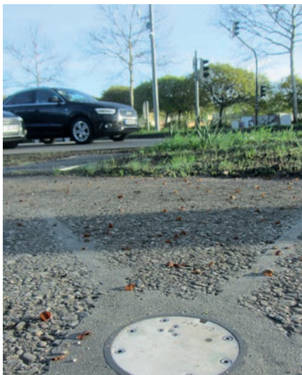
Feste Straßenwetterstation an der Kreuzung Ostring/Käppelestraße in Karlsruhe: auf dem Radweg eingebaute Sensorik sowie im Hintergrund die Sensorik für die Messung der atmosphärischen Parameter Foto: Tim Reuber
