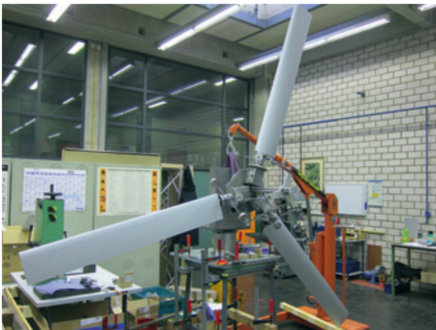
Prototyp einer Kleinwindanlage (6 kW) der HsKA beim Zusammenbau in der Werkstatt von EIT
