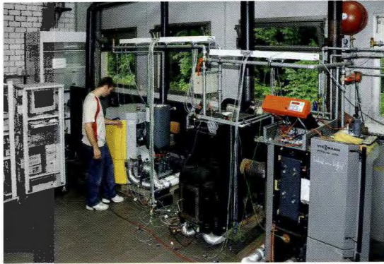
Abb. 2: Anordnung der Holzverbrennungsanlagen im ISIS-Technikum. Von rechts: Stückholz-Heizkessel (Viessmann GmbH, Allendorf), Stückholz-Kachelofeneinsatz (Brunner GmbH, Eggenfelden), Pellet-Heizkessel (Ritter Energie- und Umwelttechnik GmbH, Karlsbad), Stückholz-Kaminofen (Wodtke GmbH, Tübingen-Hirsau). Linker Bildrand: Messdatenerfassung und Prozessregelung, Feinstaubanalyse
