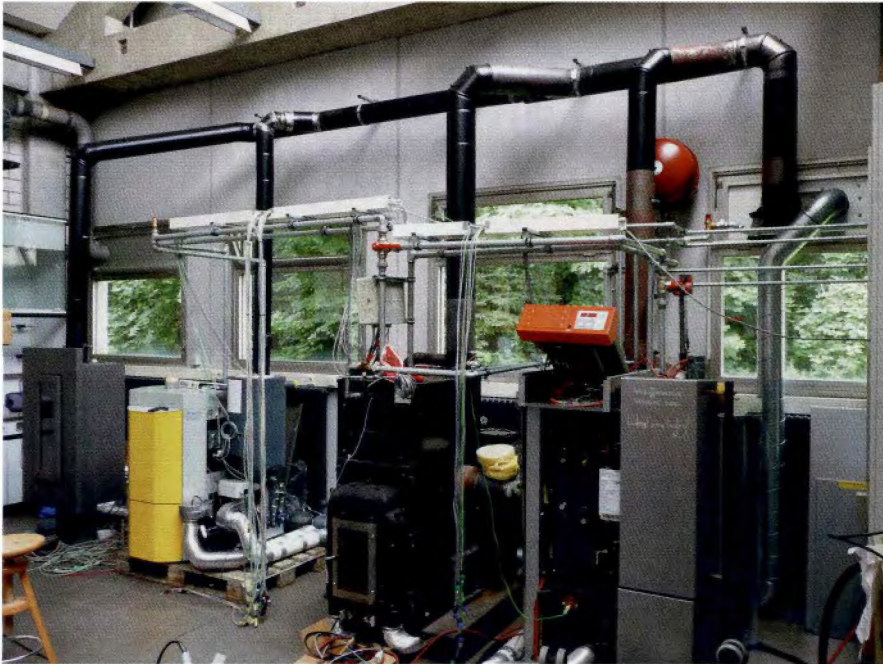
Derzeit im ISIS-Experimentierlabor installierte Holzverbrennungsanlagen. Alle wurden mit Abgas- und Temperatursensoren nachgerüstet, um die Verbrennungsqualität durch automatische Zuluftregelung zu optimieren.
