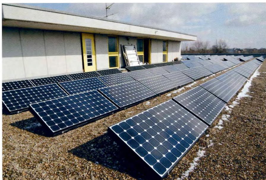
Die neue Solaranlage auf den Gebäudedächern der Hochschule
