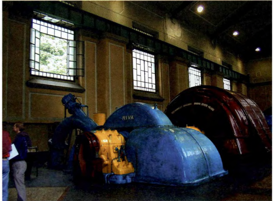
Maschinenhaus des Wasserkraftwerkes Mese/Chiavenna
