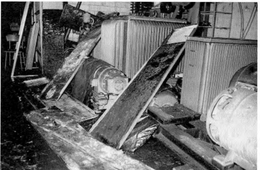
Abgebrochene Kabelträger zwischen Motoren und Transformatoren
