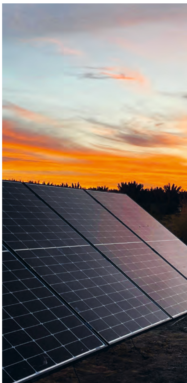
Abb. 3: PV Anlage zur Energieversorgung am Standort Goulmima (Foto: Edgardo Kurz)
