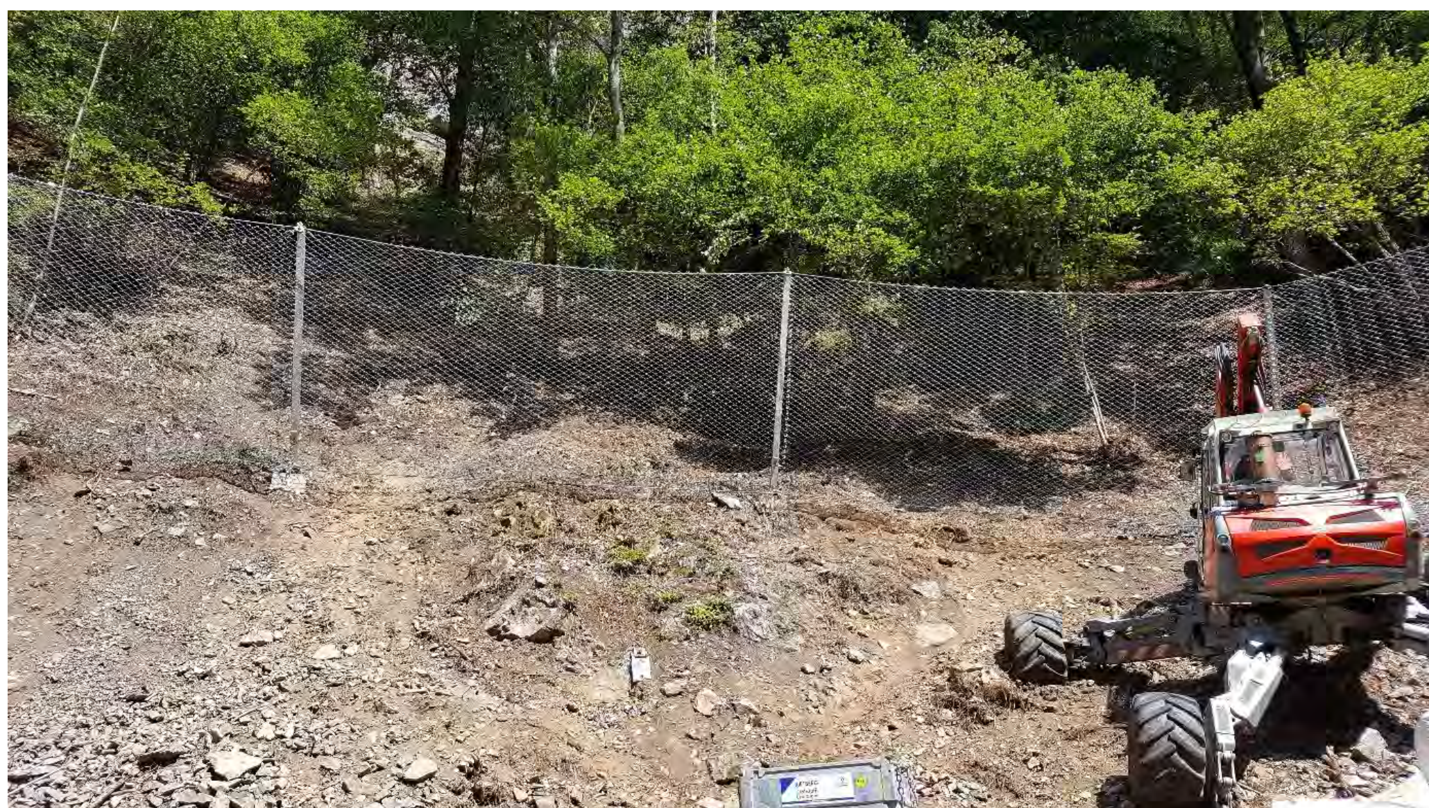
Fangzaun als Sicherungsmaßnahme
