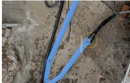
Abb. 1: Einmessung eines Stromkabels mit der Lovion Measure App
